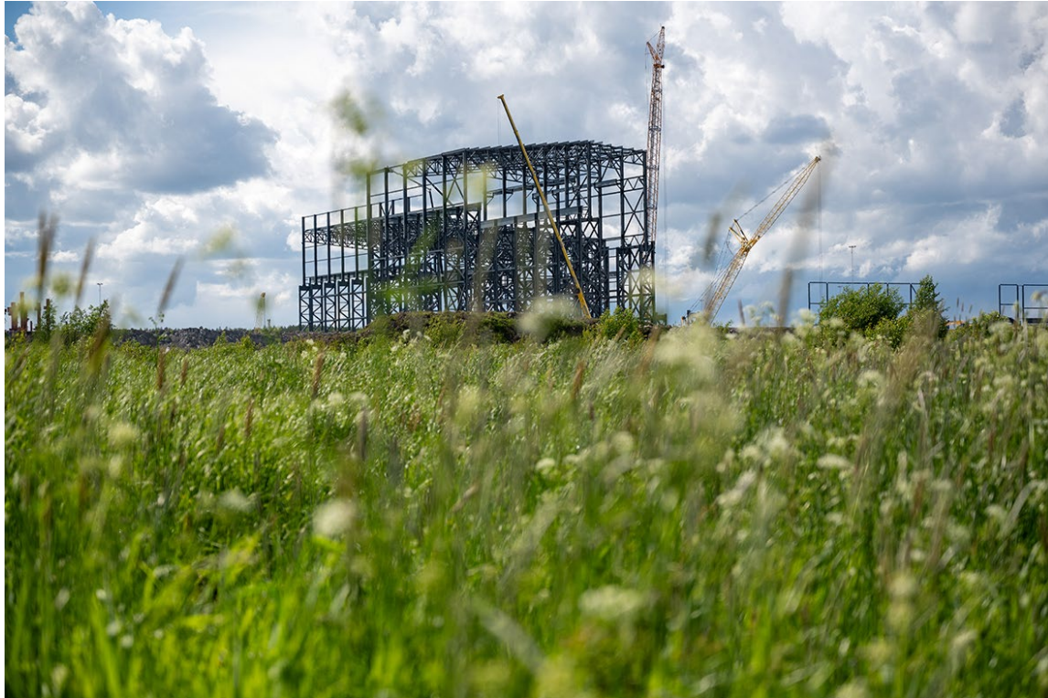
H2 Green Steels anläggning i Boden växer fram. Foto: H2 Green Steel
